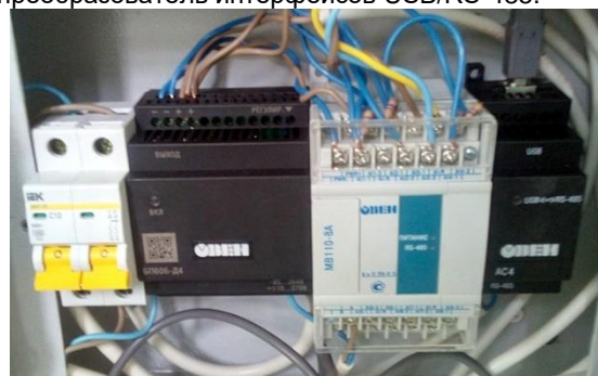
Рис. 3. Коммутационный шкаф стенда
